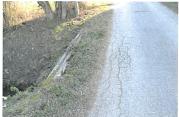
6.kép: Letört burkolatszél a megfelelő megtámasztás hiányában.
