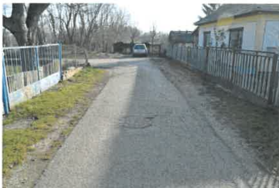
10.kép: Burkolat állapot 0+250 km sz. környezetében.
