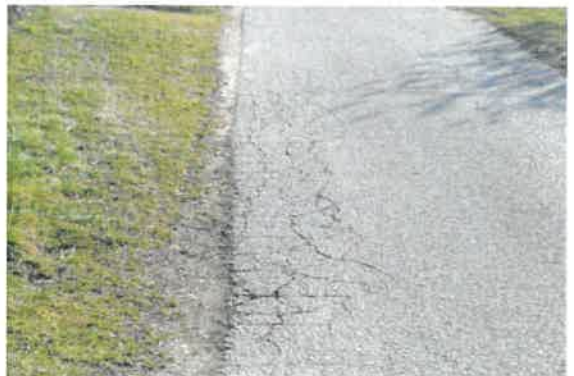
8.kép: Burkolat állapot 0+200 km sz. környezetében.
